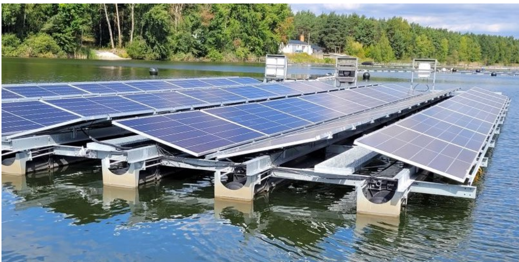
Abb. 7: Blick von Süden auf die FPV-Anlage C (System FloatingSolar)
