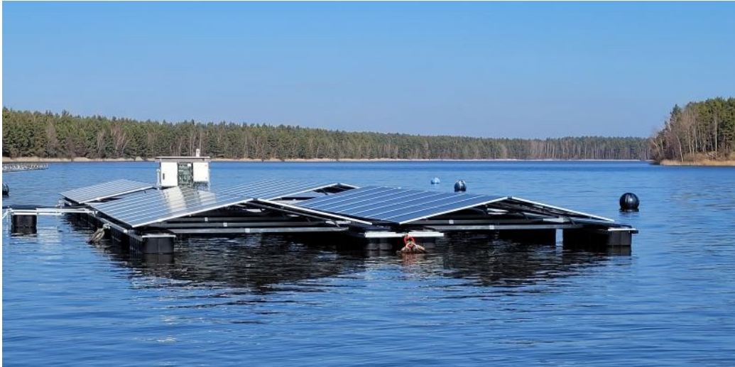
Abb. 5: Blick von Süden auf die FPV-Anlage A (System Zimmermann)
