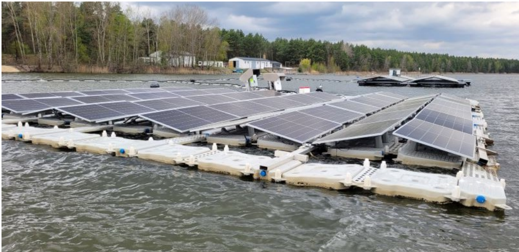
Abb. 6: Blick von Süden auf die FPV-Anlage B (System ProFloating)
