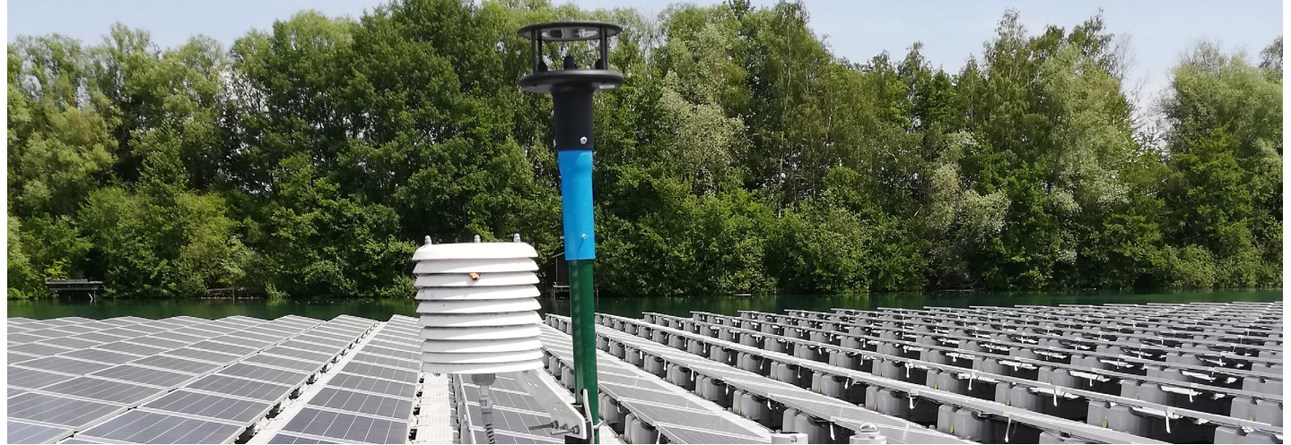
Messgeräte prüfen Wind und Temperatur an der Floating-PV-Anlage in Renchen/Baden.
